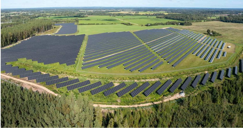
Evecon Kopli päikesepark 16MW
